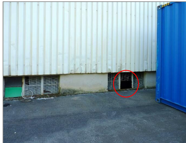
Abbildung 15: Kellerfenster auf der Westseite der Halle 4 mit vermutlich dauerhafter Öffnung (Kreis).
