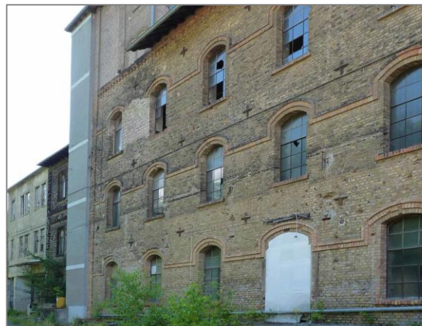
Abbildung 7: Der Gebäudetrakt 19-20 wird vermutlich von Gebäudebrütern genutzt (Hausrotschwanz).
