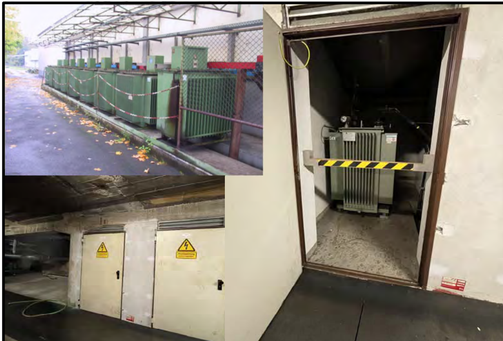
VF 20 - Trafostationen und Gleichrichter, beispielhaft für die auf Werksgelände vorhandenen mind. 11 Trafoanlagen. Anzahl Gleichrichterstationen ist nicht bekannt.
