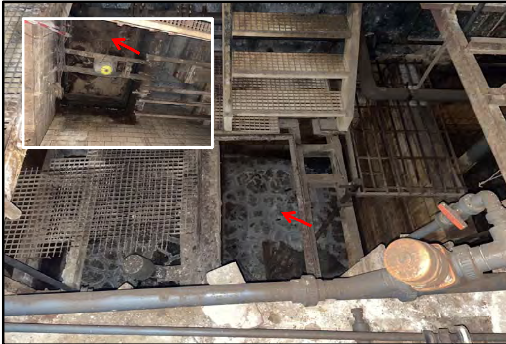
VF 3 - Abwasserbehandlungsanlage / Alte Neutralisation, hier Becken mit vmtl. schwermetallhaltigen Neutra-Schlammresten.
