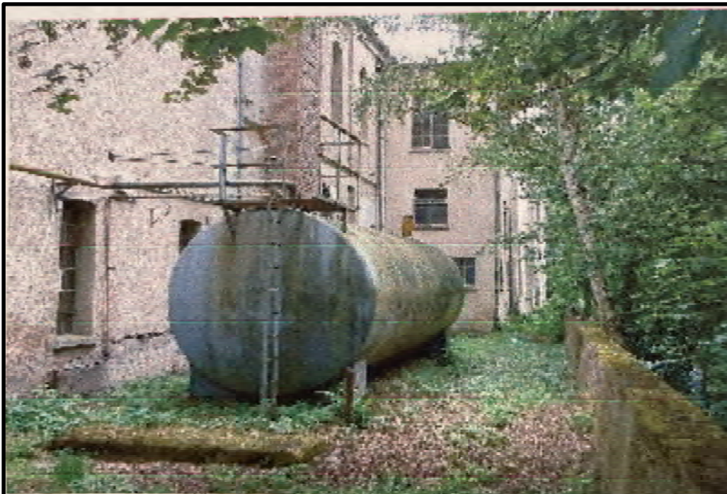
VF 8 - Alte Vergütere - 2 x 50.000 l-Heizöltanks außen, Aktenarchiv Boesner [26].
