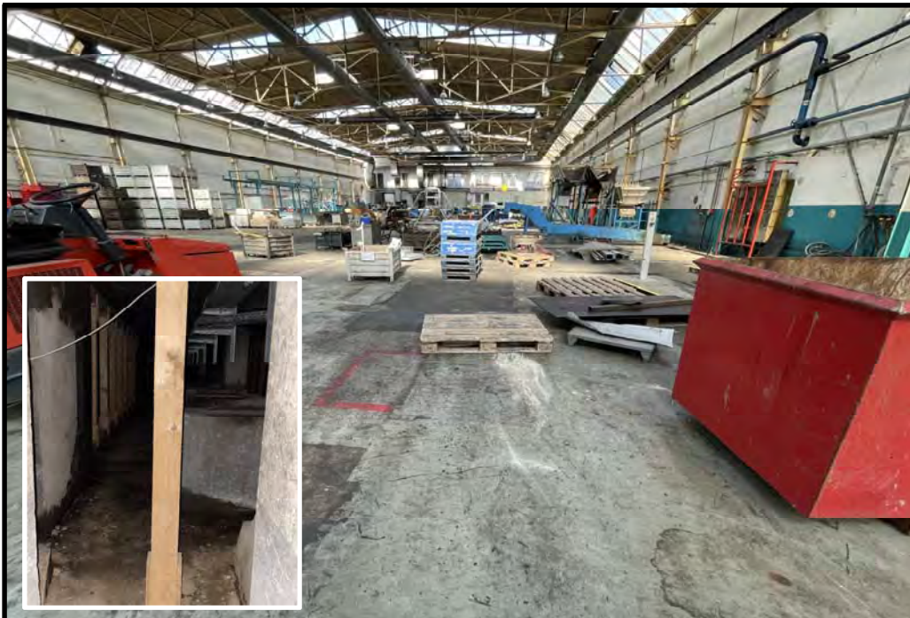
VF 12 - Produktionshalle / Halle 3 Weiterverarbeitung, Verdachtsfläche betrifft den Keller unter Halle 3 und 4. Decken wegen statischer Mängel abgestützt.
