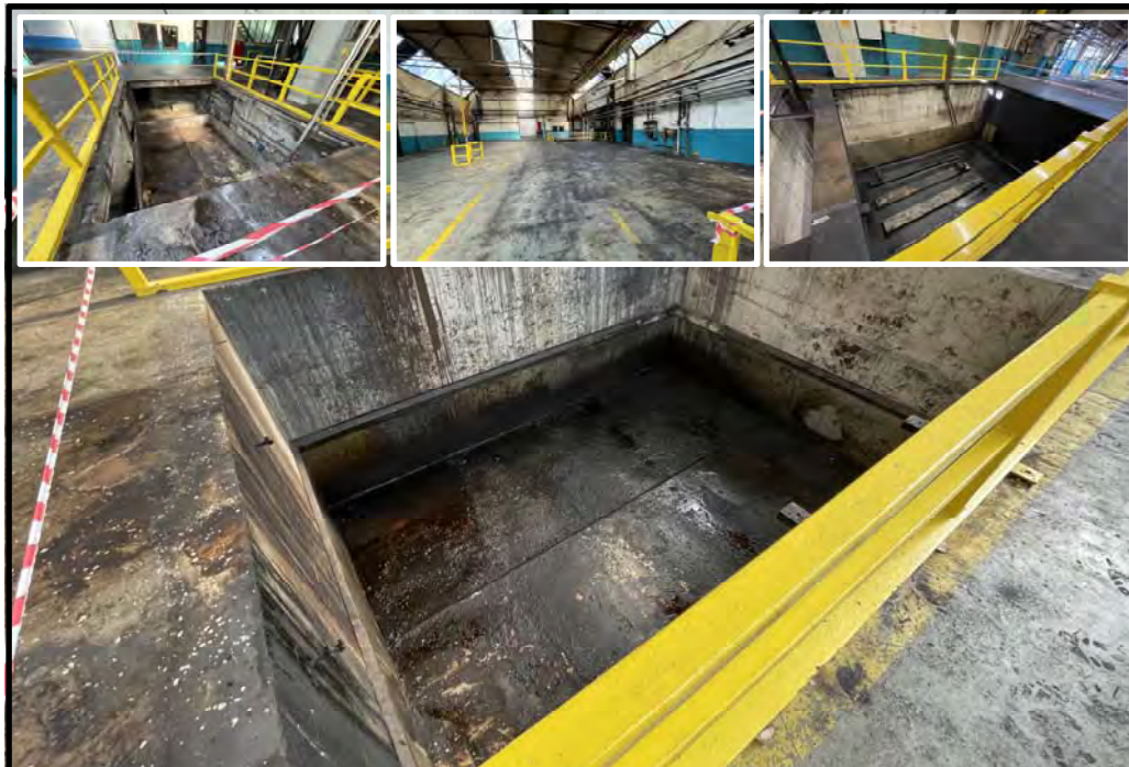
VF 14 - Produktionshalle / Halle 6 + 7 - Neue Vergütere, hier Abschreckbecken für Öl oder Ölemulsion.
