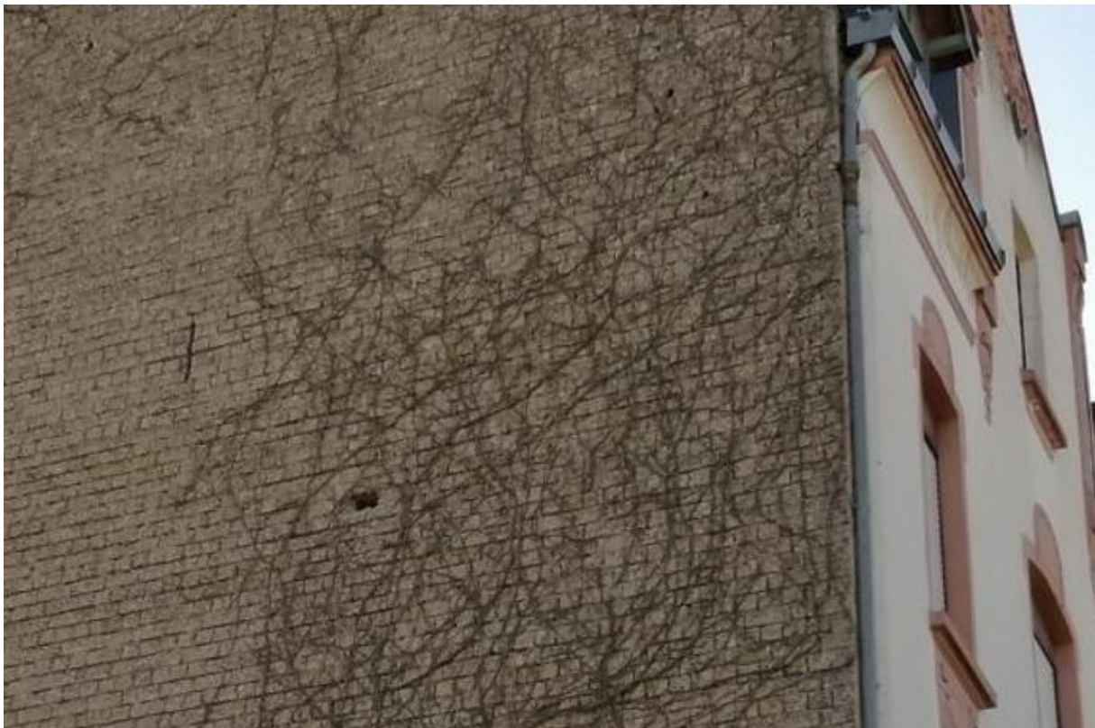
Abb. 9: Fassade mit Löchern/Spalten (D)
